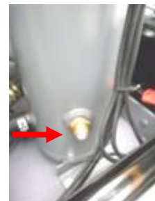
Kontrollschauglas am Kompressor
